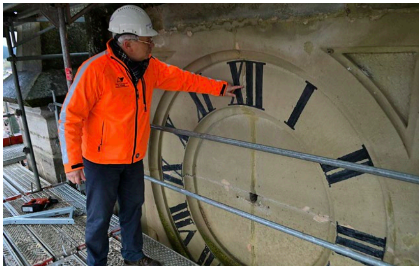
Endommagée par le temps et les intempéries, la roche se fragmente et se détache à de nombreux endroits de l'édifice.
